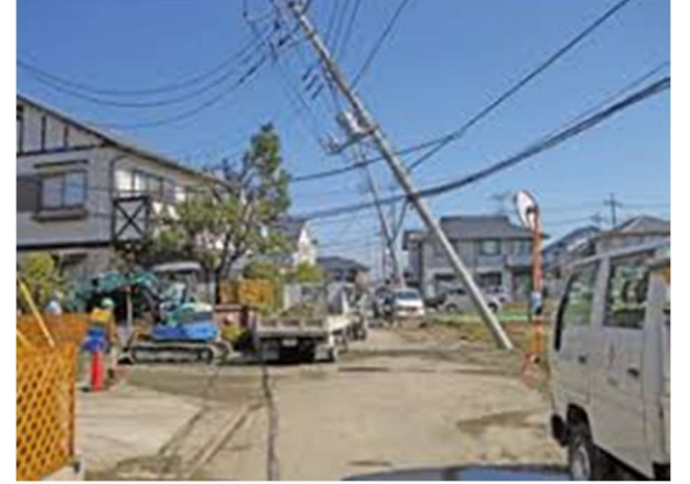
液状化（久喜市栗橋地区）
